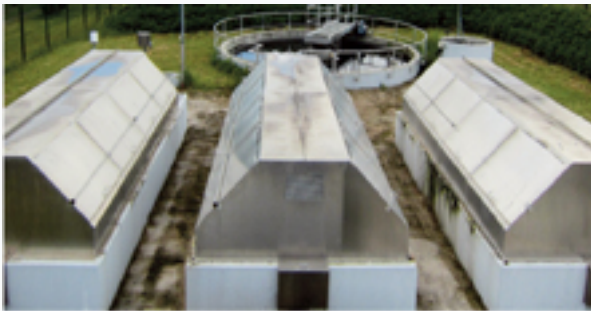
La station d'épuration Capens
