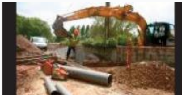
Le réseau public
