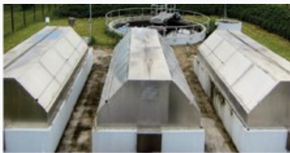
La station d'épuration Capens
